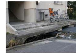
地面が沈んでできた段差(段のようになっているところ)
